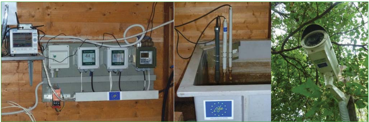
FIGURA 22. Strumentazione di monitoraggio da remoto.
