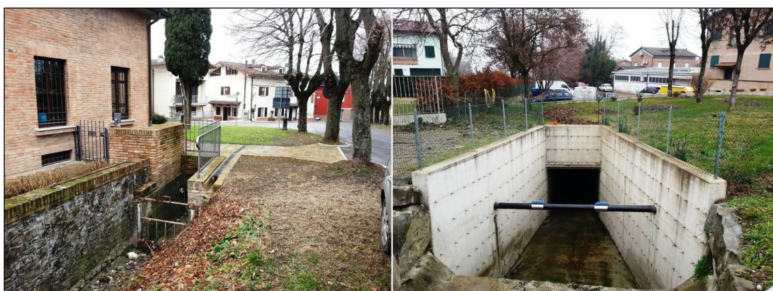
Figura 3 – Due esempi di attraversamenti tombati delle aree urbanizzate: a sinistra l'imbocco del tombamento del Rio Bianello subito a monte di Quattro Castella; a destra il sottopasso tombato del Rio Enzola nei pressi dell'area artigianale di Bibbiano.
