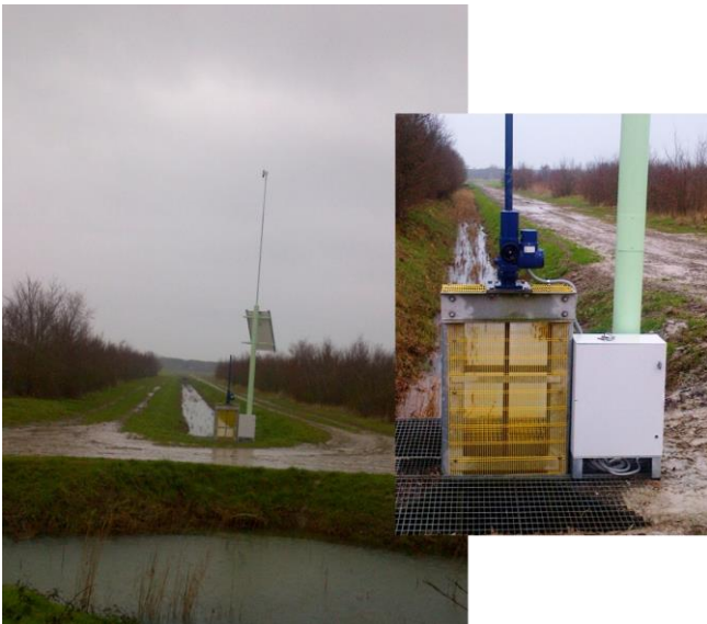
Figura 10. Paratoia attrezzata con attuatore meccanico e controllata dal sistema automatizzato
