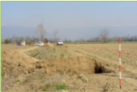
3. Rosà (VI): campo di sub-infiltrazione
