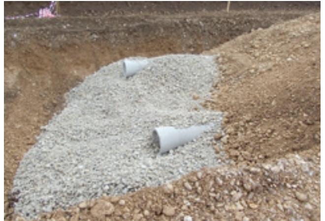
Foto 20 - Lavori di realizzazione della trincea (si notano le due linee di infiltrazione)
