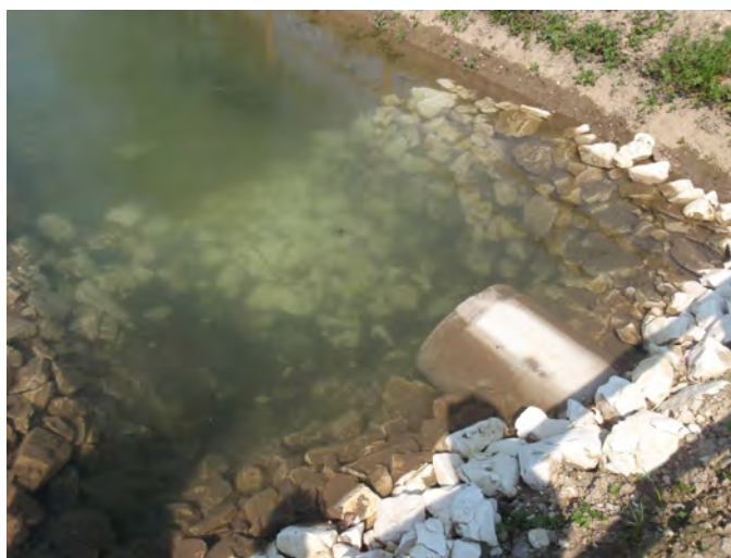
Fig. 13 – immagine del sistema di sedimentazione presso impianto AQUOR di Schiavon (VI), particolare inlet (fonte: CB_BRE)
