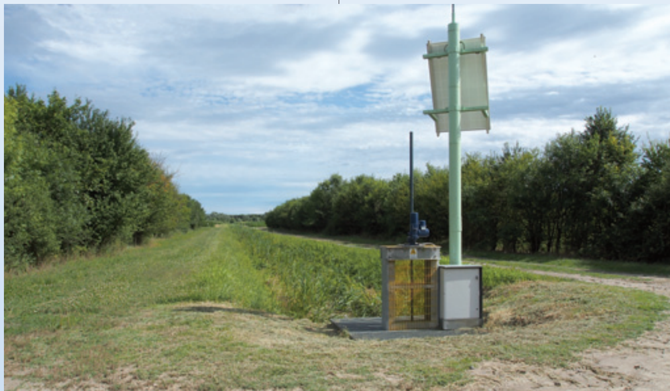
Foto 2. Paratoia attrezzata con attuatore meccanico e controllata dal sistema automatizzato.
