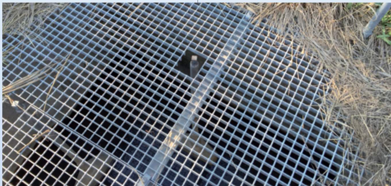
Foto 6. Manufatto di collegamento tra bacino di accumulo e bacino piccolo di raccolta dell'acqua con apertura della chiavica manuale.
