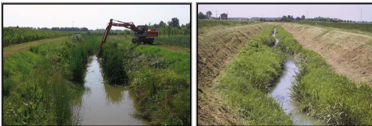
Figura 59a e 59b - Consorzio di Bonifica Acque Sorgive (VE)
