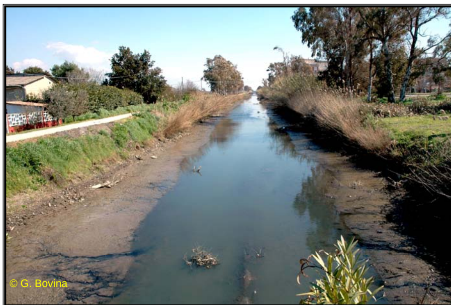
Figura 70 – Canale Colmata con livello idrico fortemente abbassato. Si noti il drenaggio laterale fortemente organico
