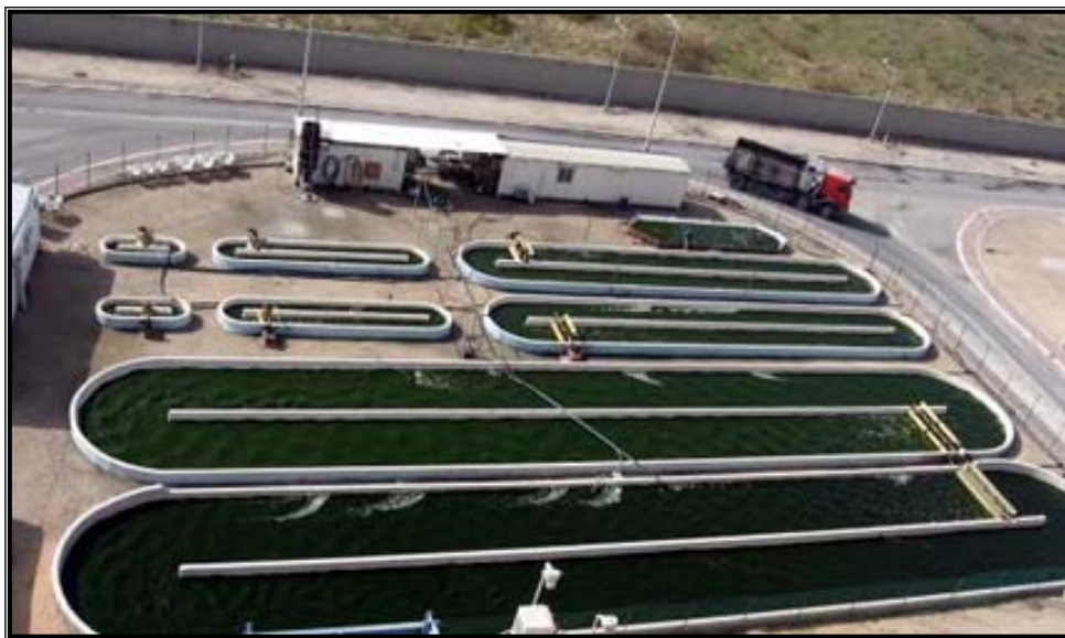
Figura 4 – impianto di fitodepurazione a fitoplancton
