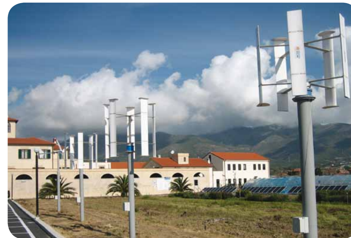
Figura 7. Aerogeneratori, impianto microeolico.
