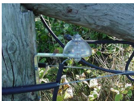
CAMPANELLO ANTIFULMINE A PROTEZIONE DELL'ENERGIZER
