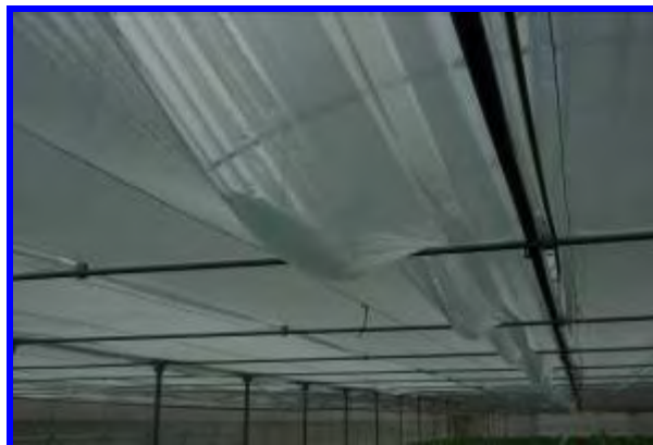
Fig. 42. Particolare di una sacca di acqua accumulata per effetto dell'umidità dell'aria.
