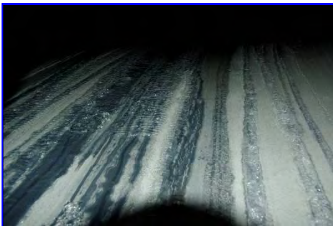
Fig. 37. La formazione e deposito del ghiaccio nella parte centrale della copertura compresa tra due archi
